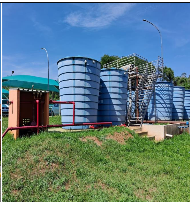
Figura 19 – Reservatórios de água para possíveis incêndios nos Blocos 28 e 30 e os demais são para o sistema da estação de tratamento de esgoto - ETE.
