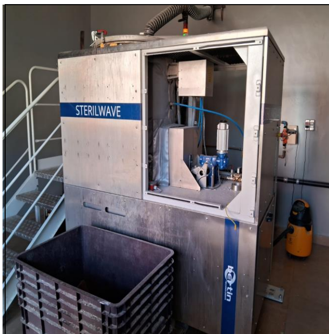
Figura 30 – Máquina autoclavagem (importada) que faz o tratamento dos resíduos hospitalares gerados para posterior coleta da empresa Cheiro Verde Ambiental que dará a destinação correta deste resíduo de interesse ambiental.
